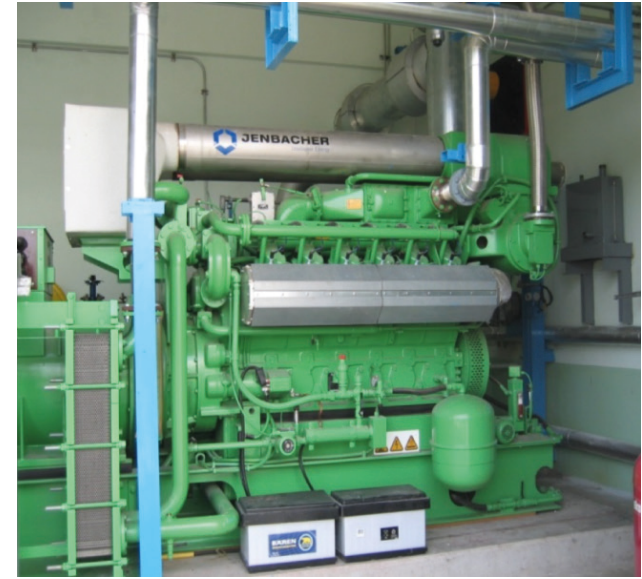
Kuva 5-2. Jenbacher" -kaasumoottori (660 kW) asennettuna. (Oulun Jätehuolto)
