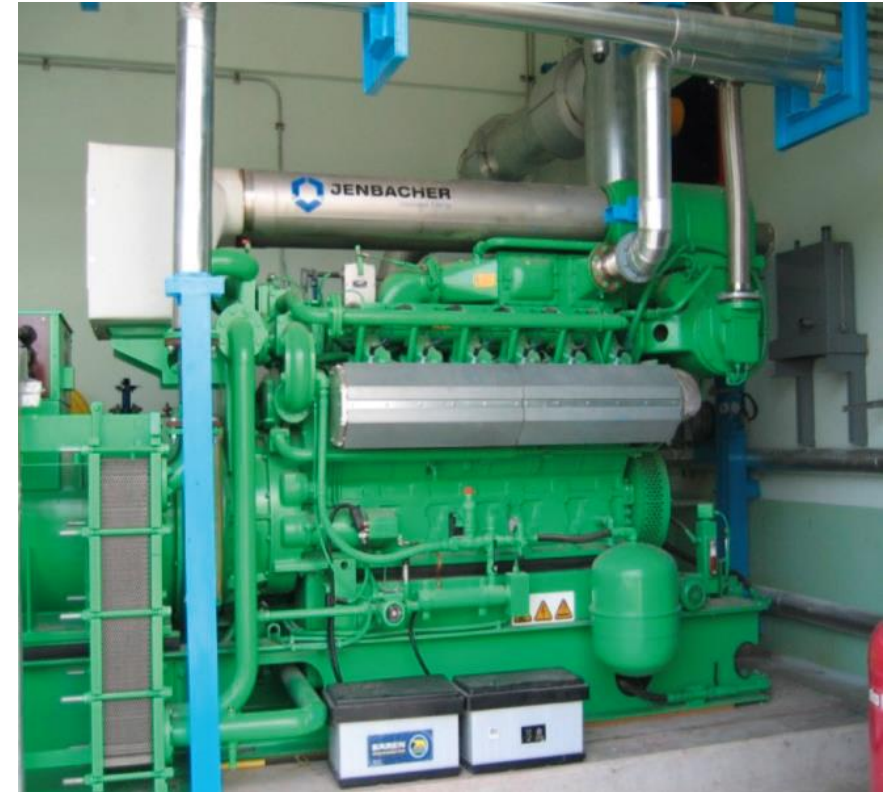
"Jenbacher" -kaasumoottori (660 kW). (Oulun Jätehuolto)
